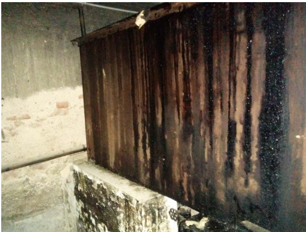
Particolare serbatoio nafta a piano interrato
