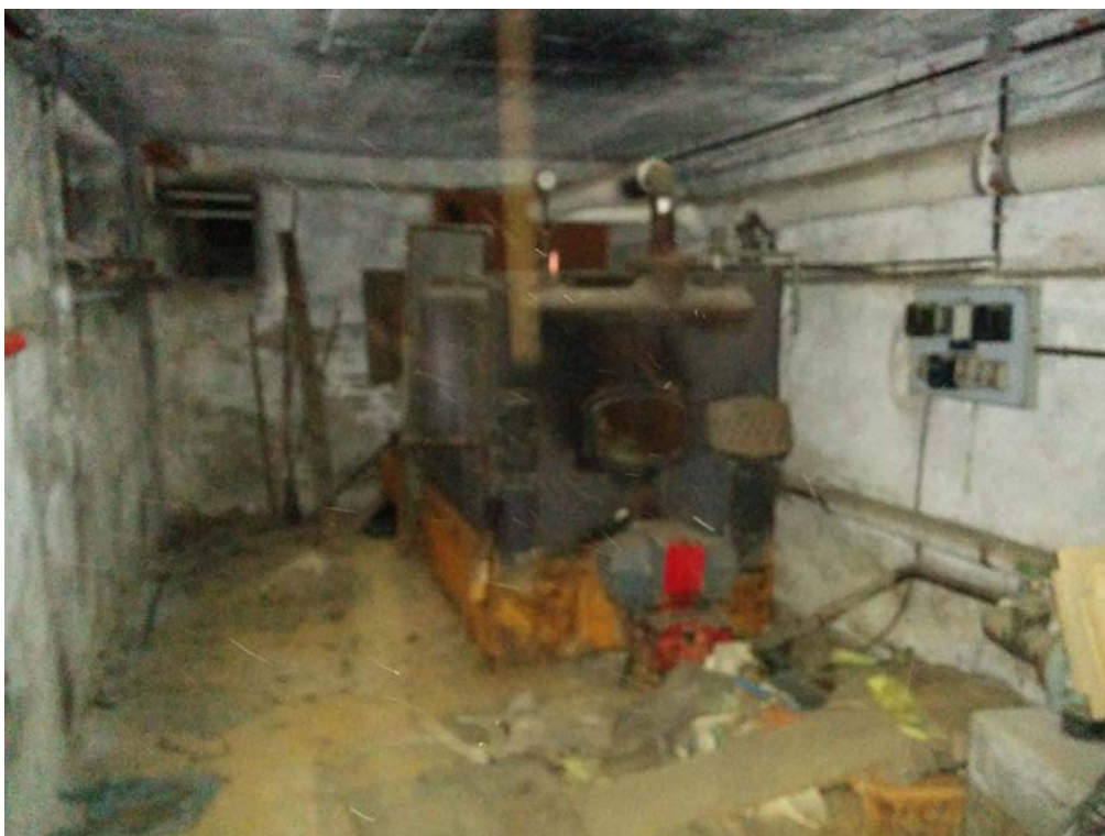
Vecchio generatore di calore a piano interrato
