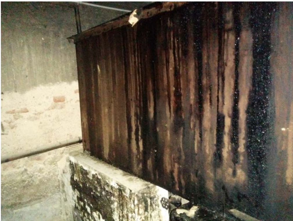
Particolare serbatoio gasolio a piano interrato
