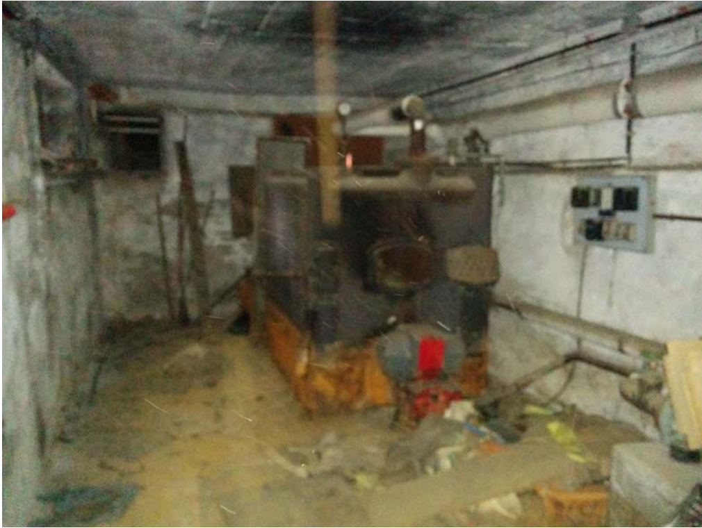
Vecchio generatore di calore a piano interrato
